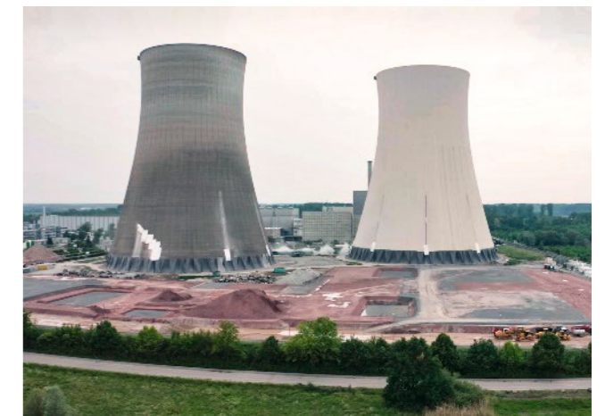
Abb. 9: Kühltürme URA links und ZT 21 rechts, Foto: EnBW
